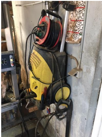
Billede 6: Forlængerledning anvendt fejlagtigt, som erstatning for en permanent løsning
