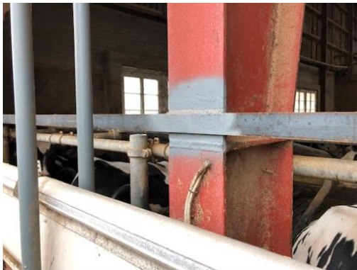
Billede 3: Potentialeudligning udført med på-svejset båndstål på stålramme/spær. Denne svejste forbindelse erstatter den tidligere, der ses som en på boltet ledning på spæret (Foto: Jesper Sørensen)
