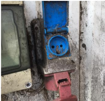
Billede 1: Det ses ofte, at CEE-stikudtag, kombineret med 230V er defekte med åbenstående eller helt manglende låg. Disse kan være årsag til afledningsproblemer og skal udskiftes (Foto: Jesper Sørensen)
