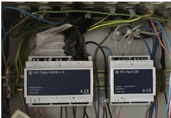
Billede 4: Eksempel på elektrisk antændt vejledning placeret i el-tavle. Dårlig forbindelse i terminal resulterer i brand (Foto: Jesper Sørensen)
